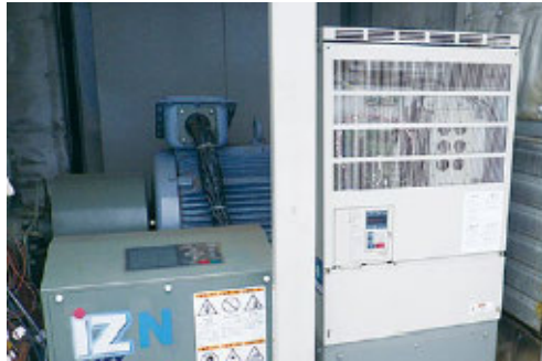
自然冷媒冷凍設備（アンモニア）
