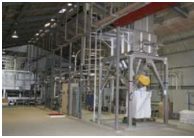
高速鶏糞処理プラント
